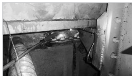
Разогретый участок кладки печи в месте ее повреждения
