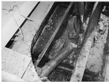
Поврежденный участок протока
